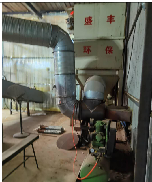
西侧镀锌锅布袋除尘器
