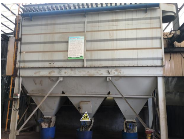
东侧镀锌锅布袋除尘器
